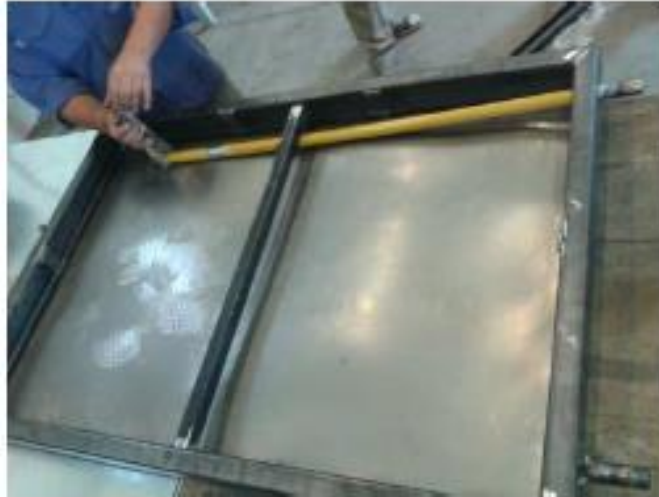
Fig. 8.3. Absorbedor-almacenador de CAIR en proceso de fabricación.
