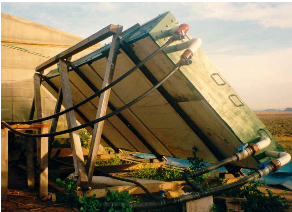
Fig. 4.14. Vista trasera del CAIT UNRC donde se observa el circuito de agua doble de entrada y salida.
